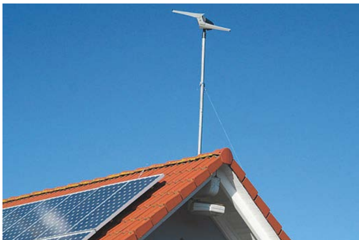
Abbildung 4 Mikrowindenergieanlage auf einem Hausdach (Bildquelle: FuSystems Skywind UG)
