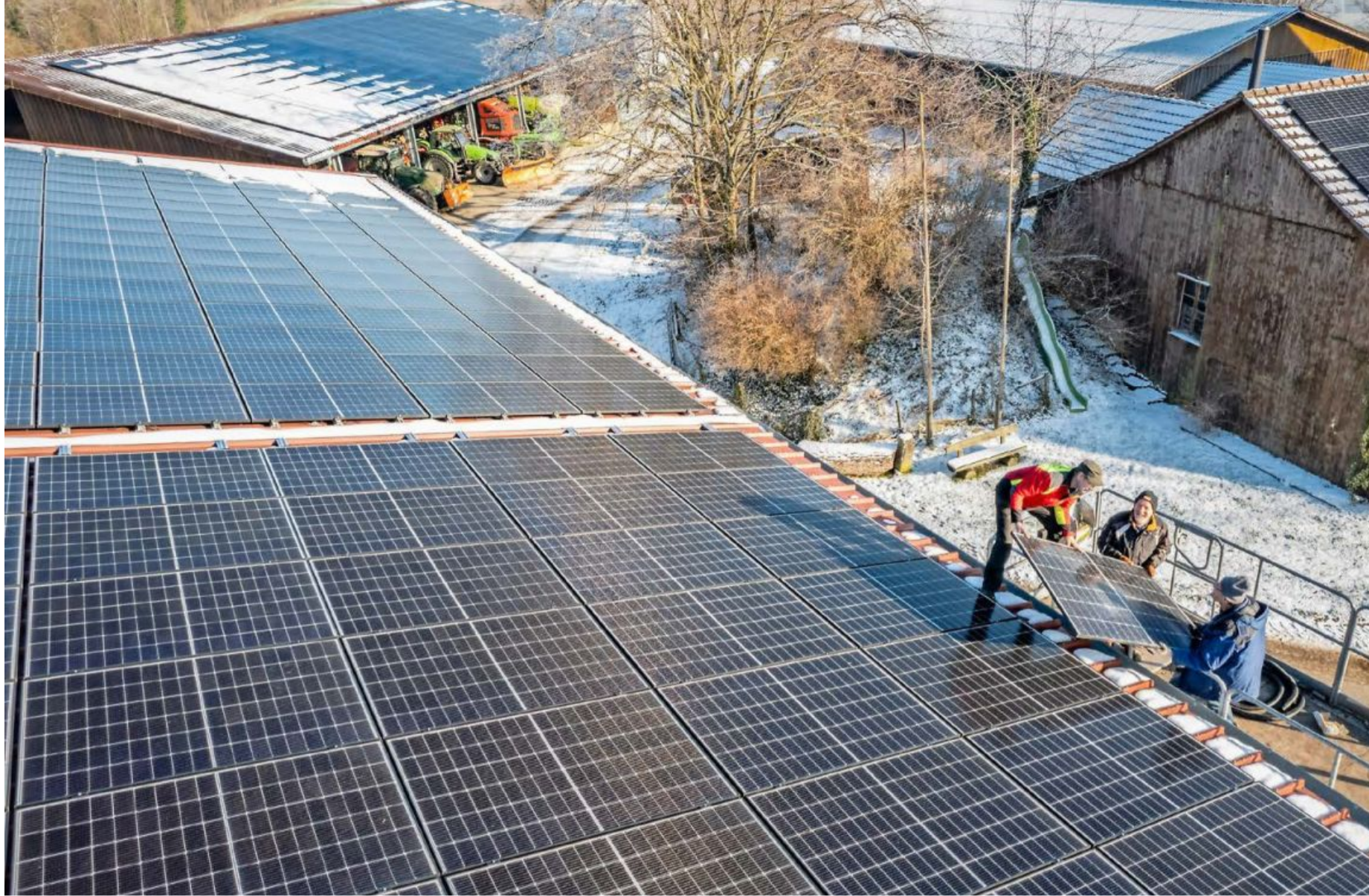
Solarstrom für Schaffhausen vom Wilchinger Berg: Werner Gysel, Urs Rüeger und Hansueli Graf (v. l. n. r.) tauschen ein Solarpanel auf dem Dach des Bauernhofs aus.
